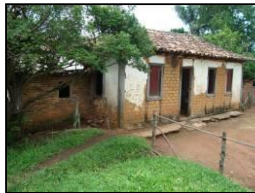
Fig. 76: Edificação deteriorada pelo tempo Fonte: Equipe Técnica Municipal
