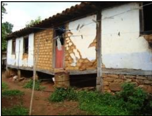
Fig. 75: Edificação deteriorada pelo tempo Fonte: Equipe Técnica Municipal
